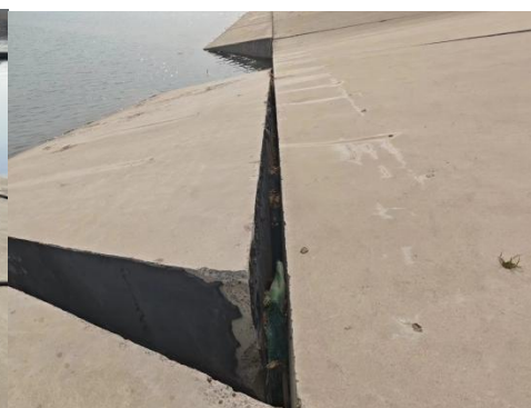
图 1-3 混凝土护坡缺失、位移
