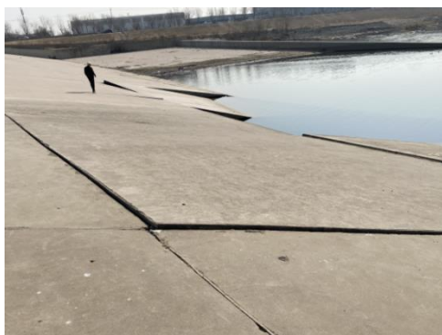
图 1-2 混凝土桥面冲毁
